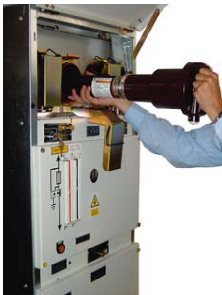
Fusarc CF 熔断器安装在CAS36柜中
